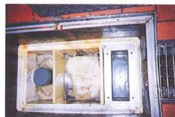
写真6 厨房排水の処理状況
